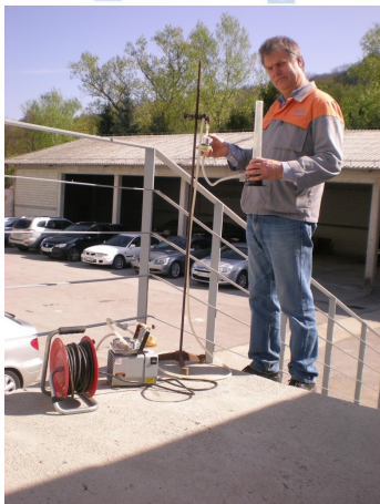
Kontrola pretoka črpalke
